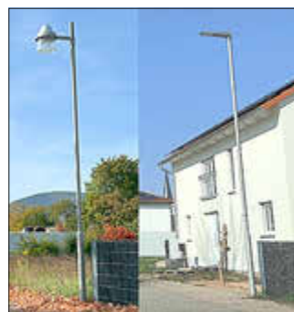
Alte (links) und neue (rechts) Straßenbeleuchtung.
