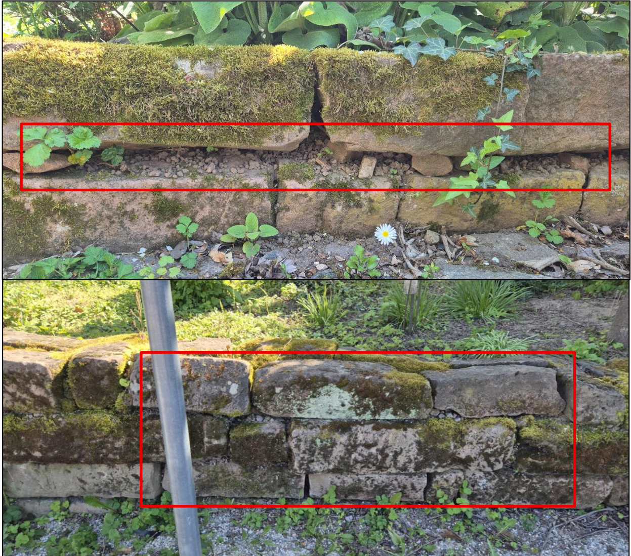
Abbildung 7: Lokale Risse in der Mauer (rot markiert)
