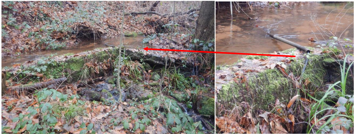
Abbildung 26 Altes Wehr mit Kabeln durch das Gewässer verlegt
