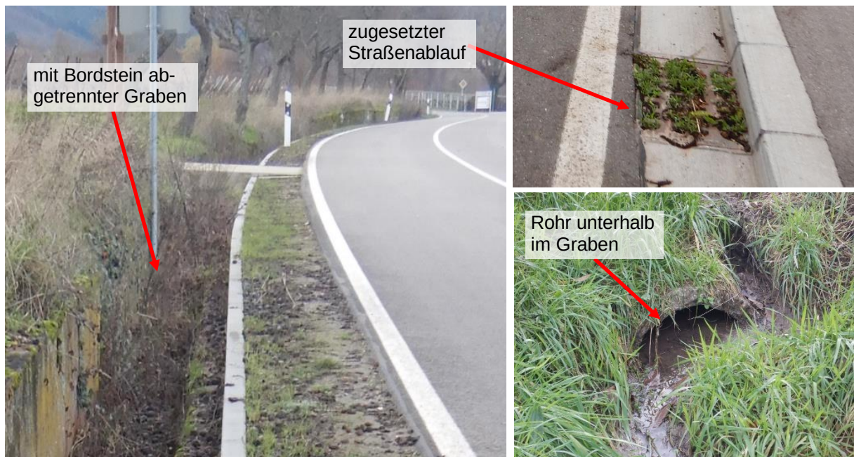
Abbildung 39 hangseitiger Graben Villastraße und zugesetzte Entwässerungseinrichtungen
