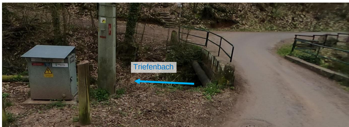
Abbildung 27 Stromkasten im Bereich Siegfriedschmiede am Triefenbach
