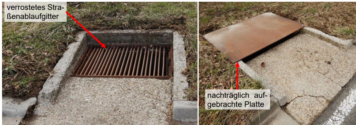
Abbildung 11 Straßenabläufe im Bereich Mündung K57 auf L512
