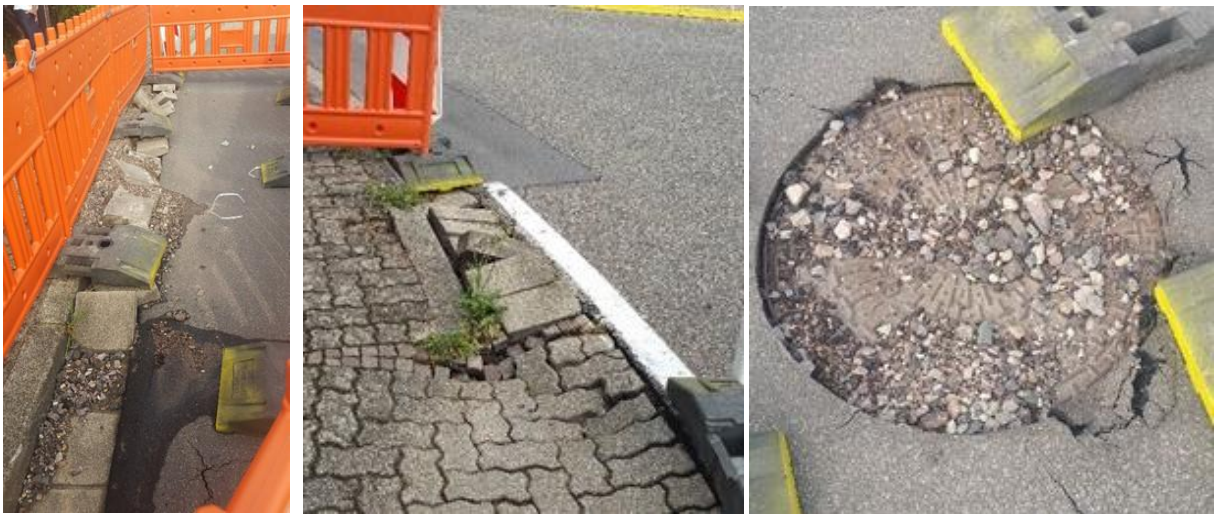
Abbildung 7 Schäden an der Böchinger Straße / Kreuzungsbereich L507
