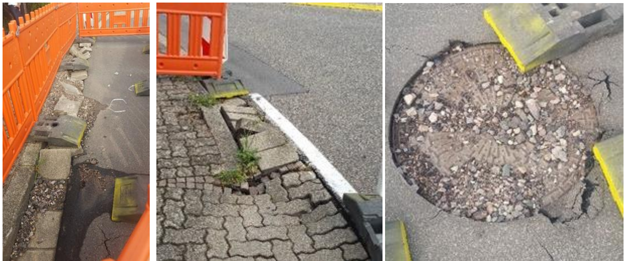
Abbildung 22 Schäden an der Böchinger Straße / Kreuzungsbereich L507
