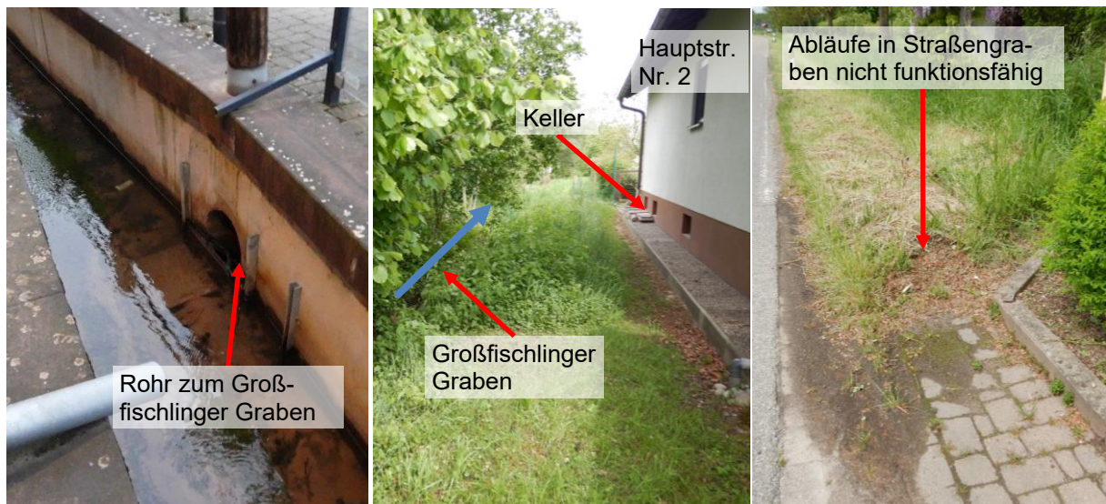
Abbildung 16 Straßenentwässerung / Verbindung Modenbach – Großfischlinger Graben / Hauptstr. Nr.2
