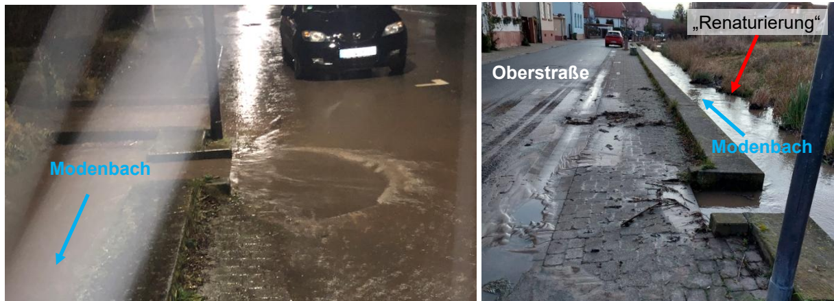
Abbildung 12 Situation Oberstraße bei und nach dem Regen in der Nacht vom 06 auf den 07.02.2022
