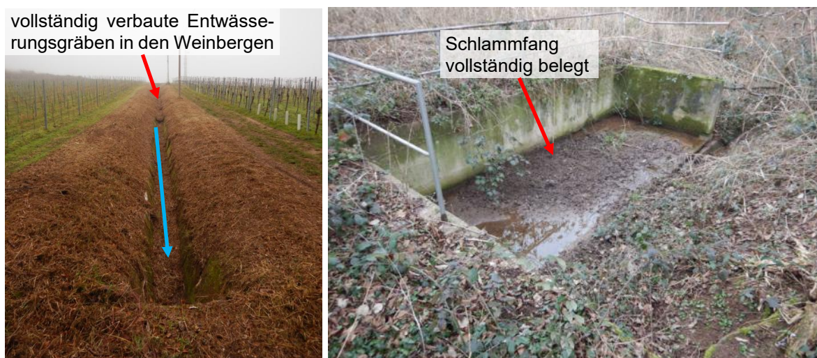
Abbildung 17 Entwässerungsgräben Weinberge / Schlammfang Beckeneinlauf
