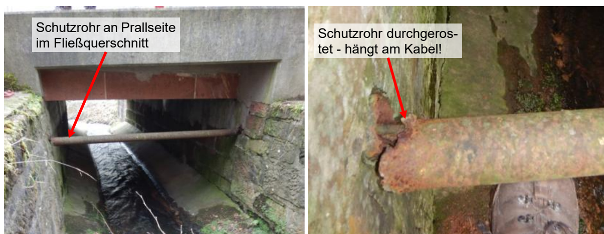
Abbildung 11 Schutzrohr unter Brücke L506 (Neuer Brunnen) von Kabel.
