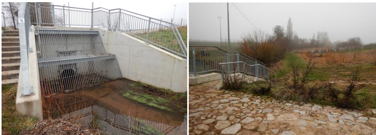
Abbildung 22 Querbauwerk und Drossel Hochwasserrückhaltebecken Modenbach
