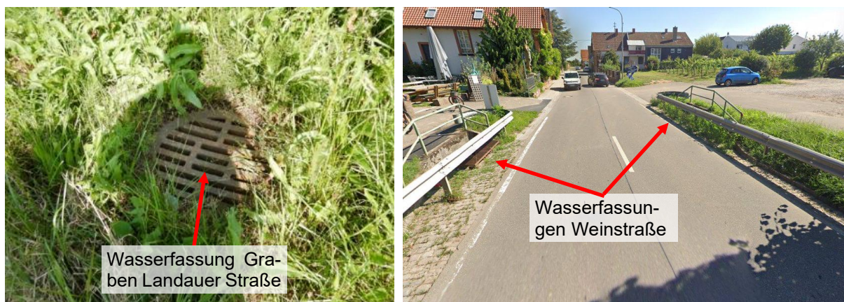
Abbildung 26 Wasserfassungen Straßenentwässerung südlicher Ortseingang Weinstraße und Landauer Str.
