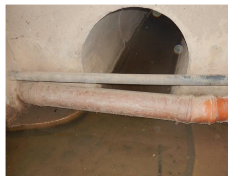
Abbildung 17 Leitungen in Verrohrung
