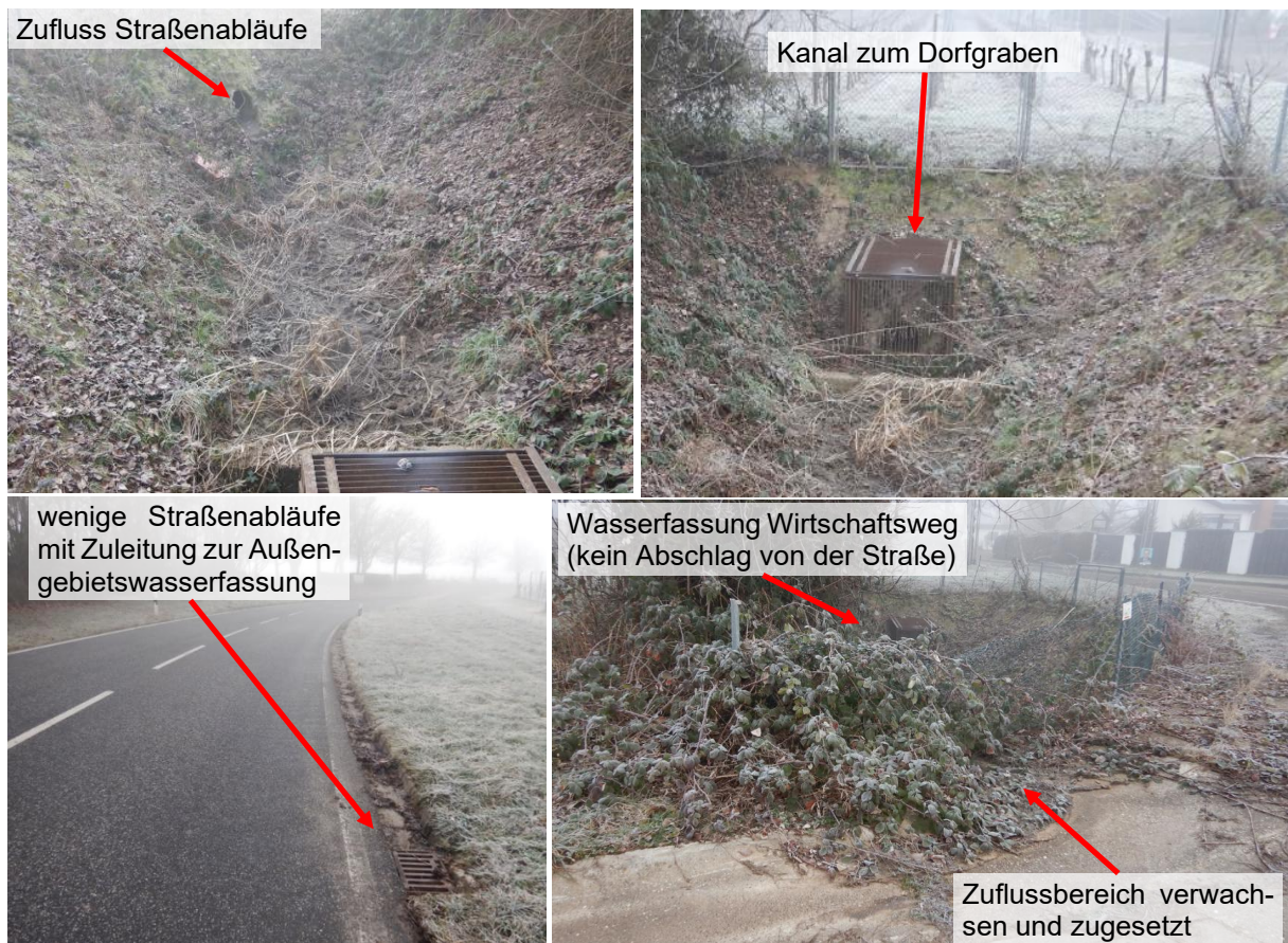
Abbildung 18 Wasserfassung K54 und Wirtschaftsweg
