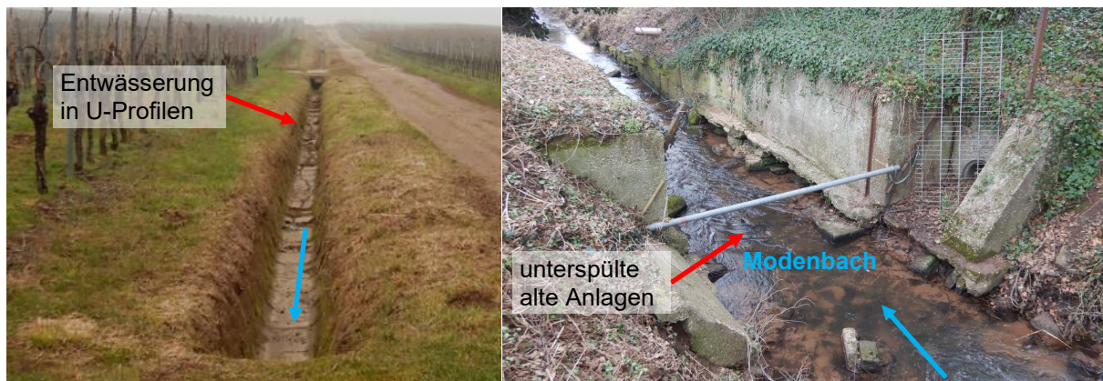
Abbildung 9 linke: Entwässerung Weinberge Eckel rechts: unterspülte Anlagen am Modenbach
