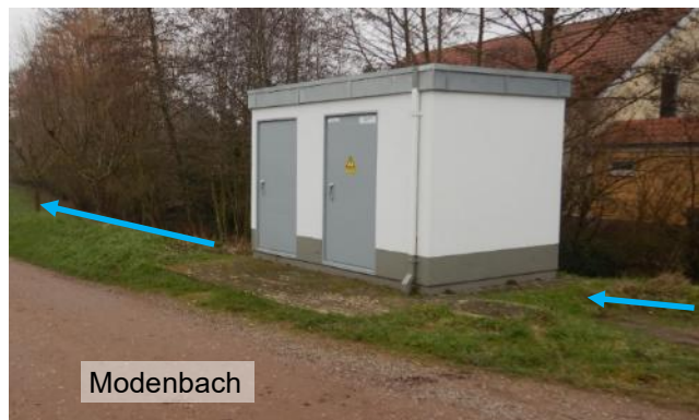
Abbildung 15 Trafostation Böschungsoberkante Modenbach östlich Steingasse
