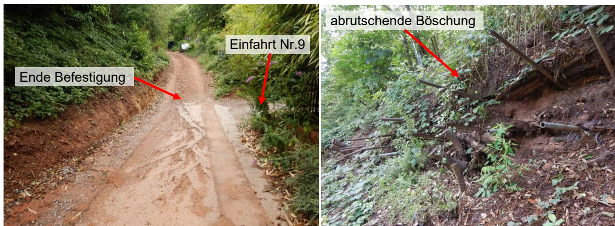
Abbildung 14 Situation im Bereich Am Annaberg Nr. 9 und Böschung oberhalb
