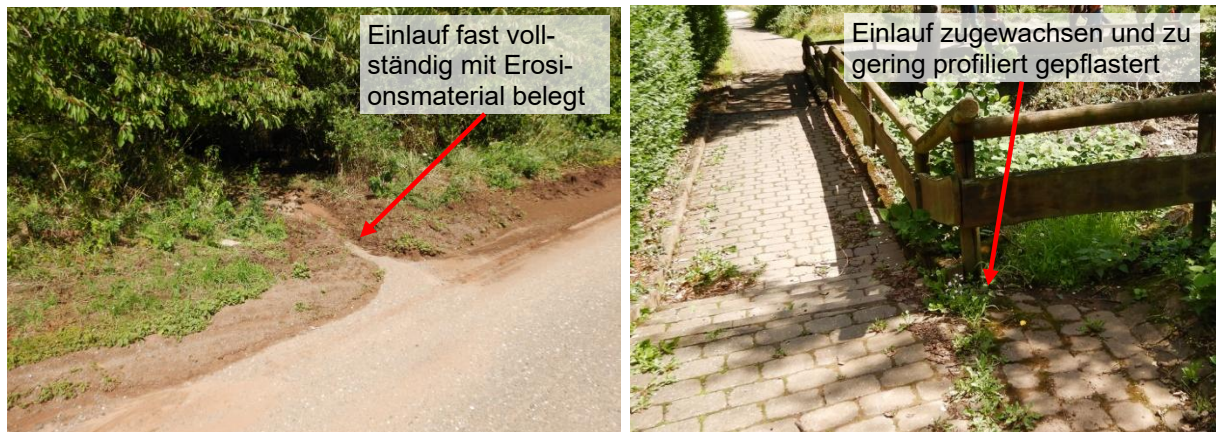
Abbildung 30 Wasserfassungen Rückhaltebecken links: nördliches zentrales Becken rechts: am St.-Anna-Weg
