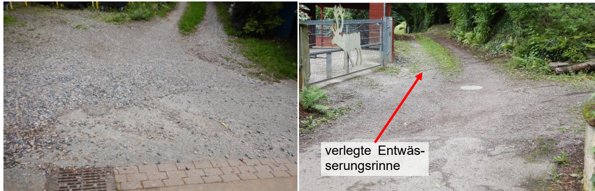
Abbildung 11 geschotterte private Zufahrten mit Erosion
