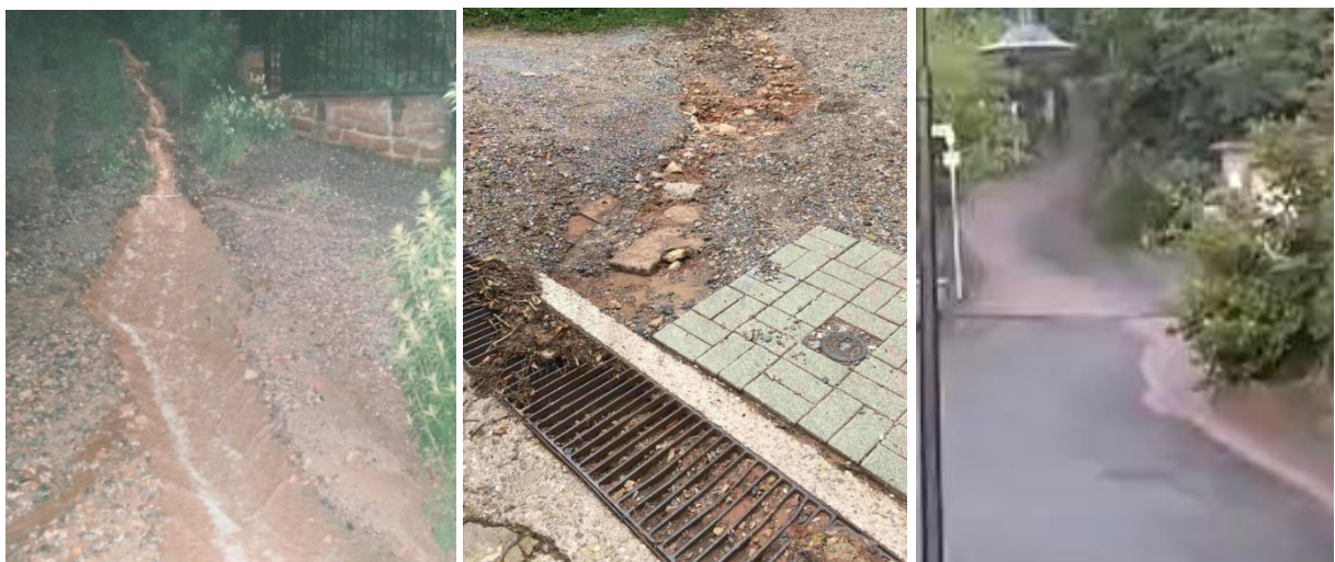
Abbildung 7 Starkregenabflüsse und Schäden an den Wegen.
