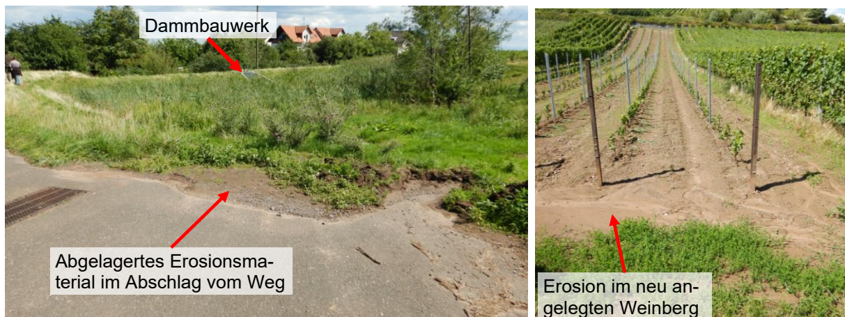
Abbildung 33 Hochwasserrückhaltebecken Kaltenbach und Erosion in neuem Weinberg
